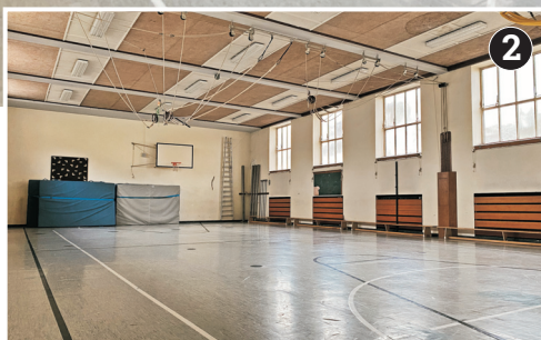
Veraltete Sporthalle mit teilweise unnutzbaren Geräten
